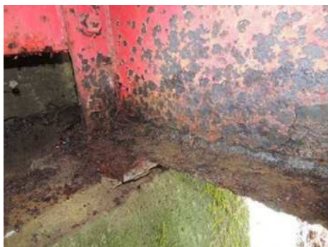
鋼桁の腐食等
