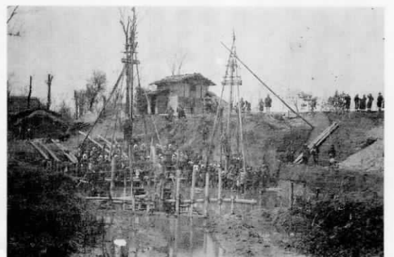
▲ 大正5年竣工の加茂郷排水機場（新潟県立歴史博物館所蔵笹川コレクション）
